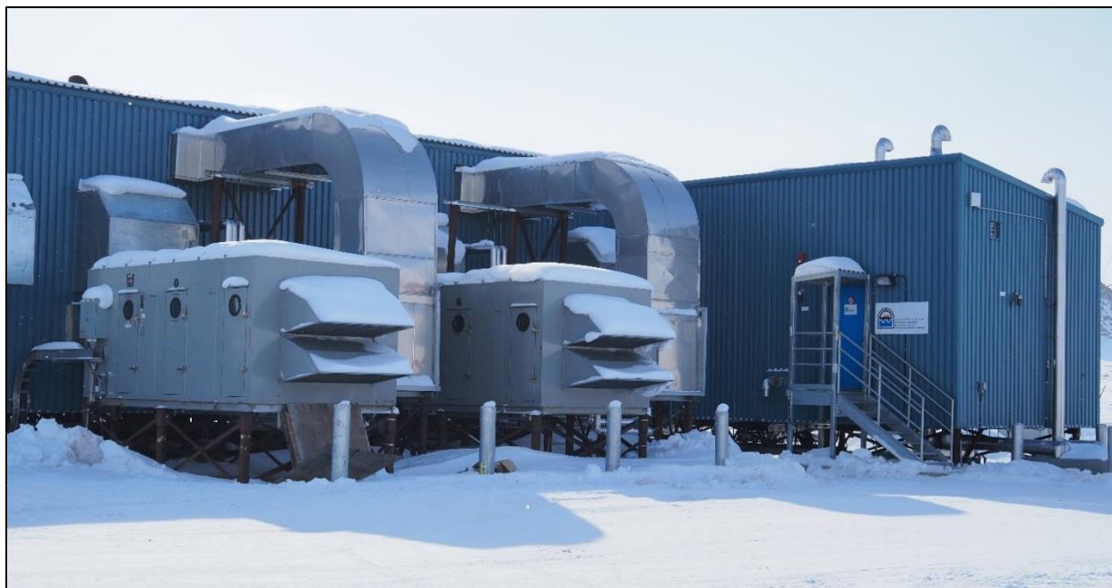
Centrale électrique de Qikiqtarjuaq, construite en 2016
