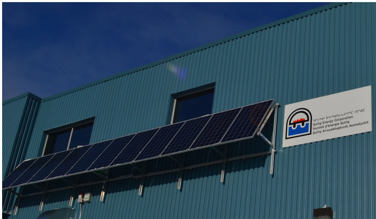
Panneaux solaires sur la centrale d'Iqaluit
